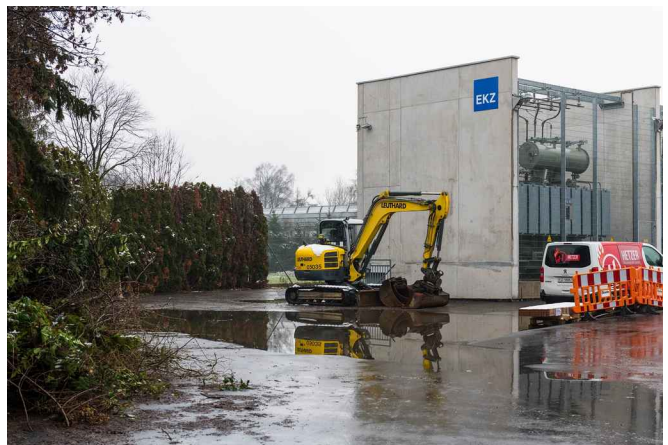
In Oberengstringen hat die EKZ gleich neben dem Rechenzentrum von Equinix eine Trafostation gebaut. Foto: Boris Mueller
