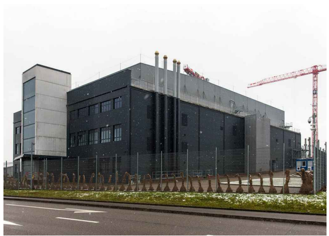
Hinter dem aktuellen Rechenzentrum von NTT in Rümlang wird gerade gebaut. Dafür musste die EKZ ihr Netz ausbauen. Foto: Boris Mueller
