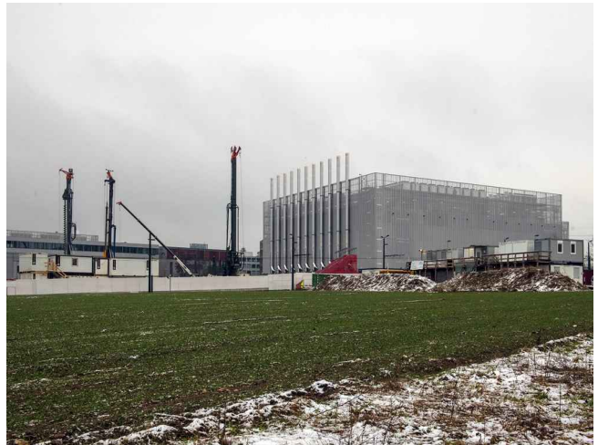
Das zweite Rechenzentrum ZUR2 von Interxion. Daneben wird bereits das nächste gebaut. Foto: Boris Mueller
